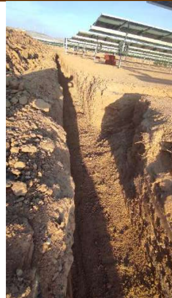
Fot 3 y 4. Zanja de BT y MT en los sectores 1 y 2 de Pitarco B
